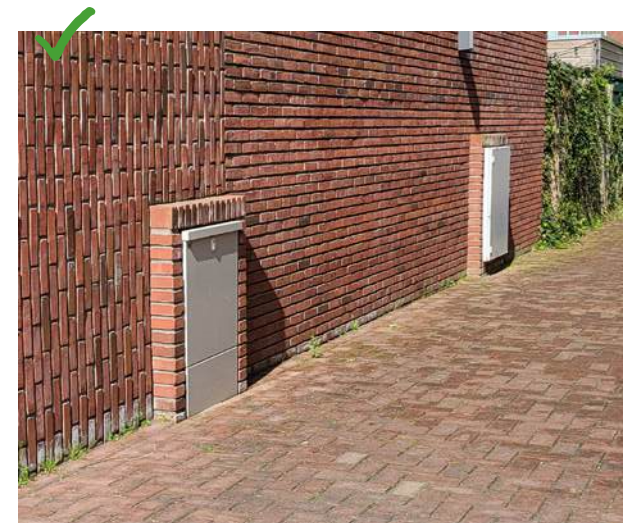
wel: cai-kasten geïntegreerd in gebouw
